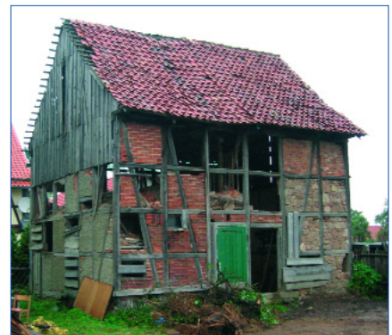
Abb. 3: Der traurige Anblick eines verfallenen Fachwerkgebäudes.
